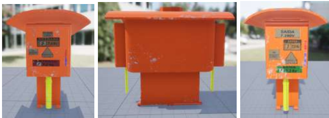
Figura 3 – Vistas do Gerador
