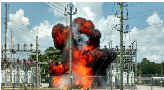
Figura 1 : Explosão de um transformador elétrico. Fonte: www.transproco.com
