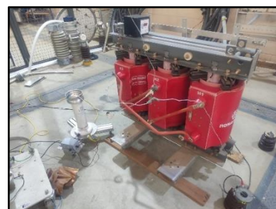
Figura 5: Medição de descargas parciais em transformador a seco
